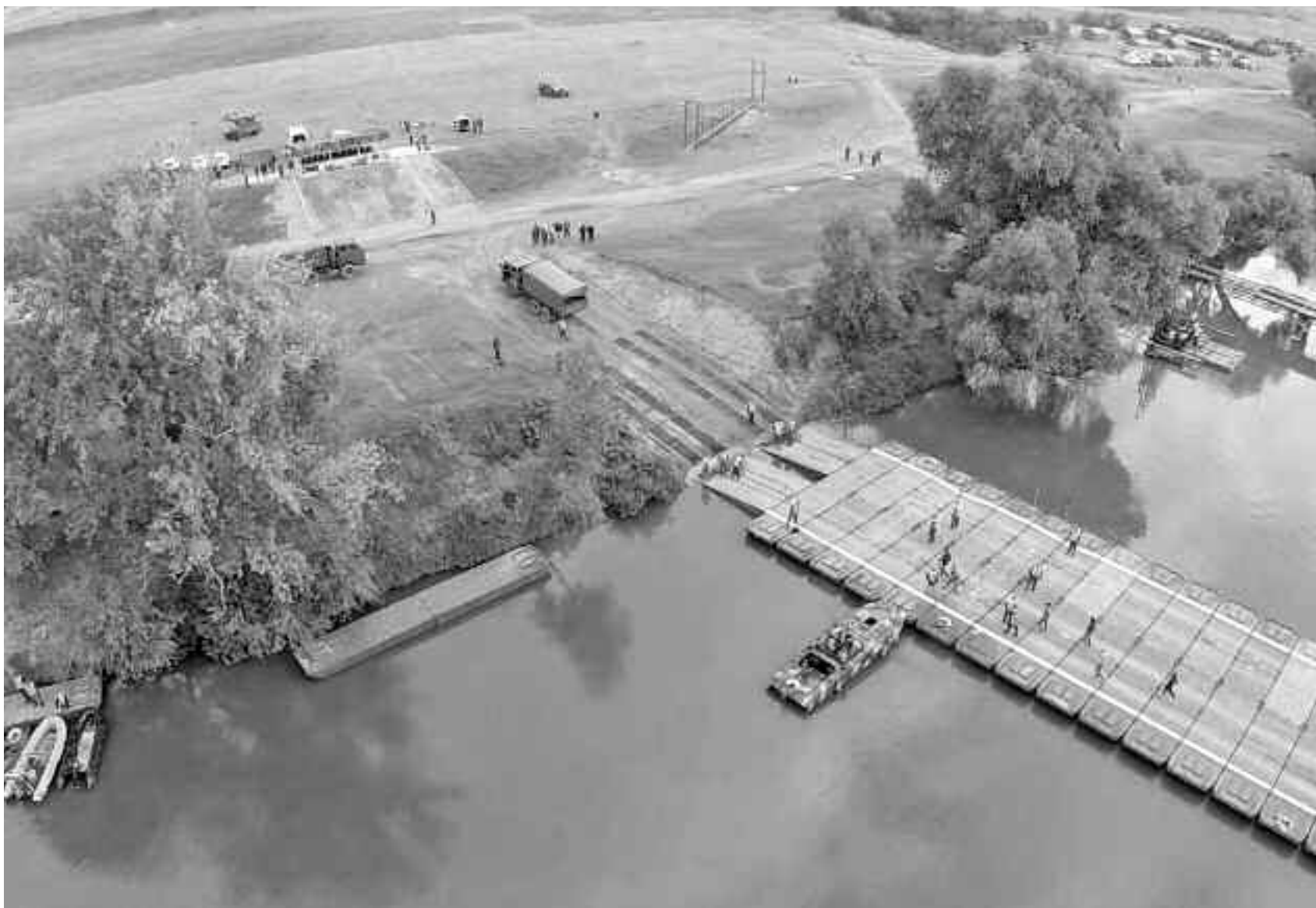
Exercițiul Multinațional Blonde Avalanche din 2016 de la Satu Mare, când militarii au construit un pod peste Someș în două zile, a fost surprins cu drona
